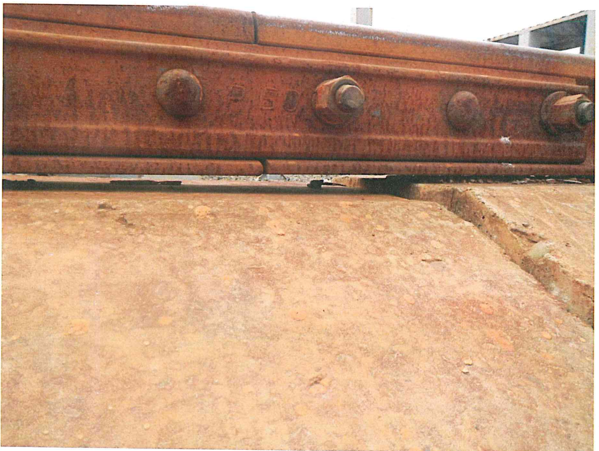
фото 2. Просадка балластной призмы и, как следствие, превышение величины упругой податливости рельсовых нитей кранового пути.
