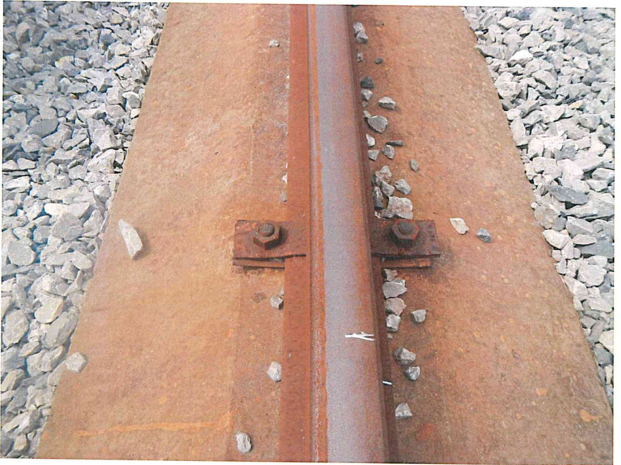
фото 3. Болтовые соединения промежуточных скреплений не имеют смазки.
