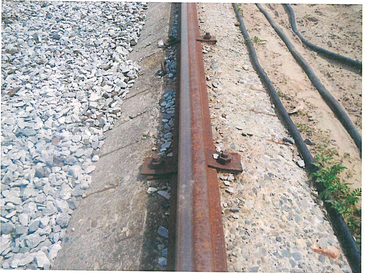
фото 1. Выкрашивание бетона балок кранового пути с оголением распределительной арматуры.
